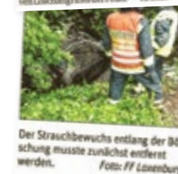
Der Strauchbewuchs entlang der Böschung musste zunächst entfernt werden. Foto: FF Laxenburg
